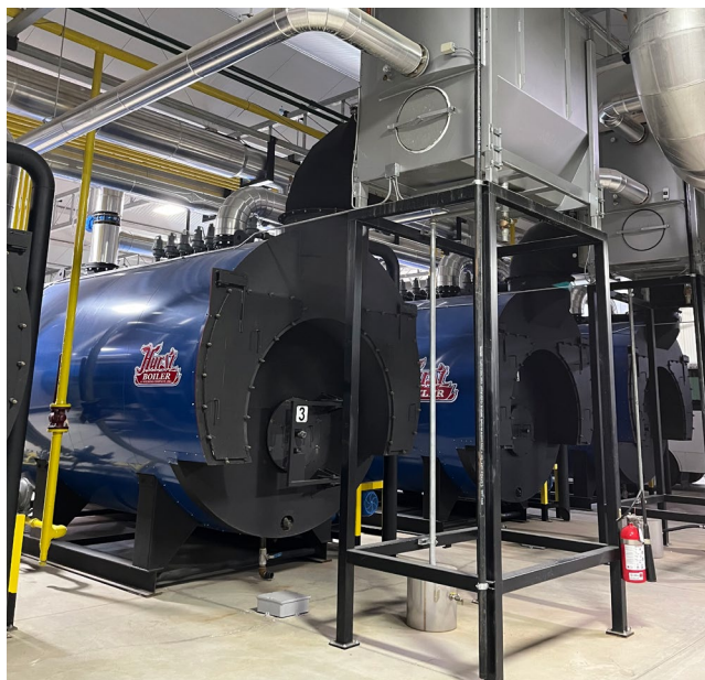
Figure 11. Chaudière au gaz naturel (partie inférieure) avec épurateur de gaz de combustion (partie supérieure) pour fournir de la chaleur et du CO 2 pour la production de légumes de serre.
