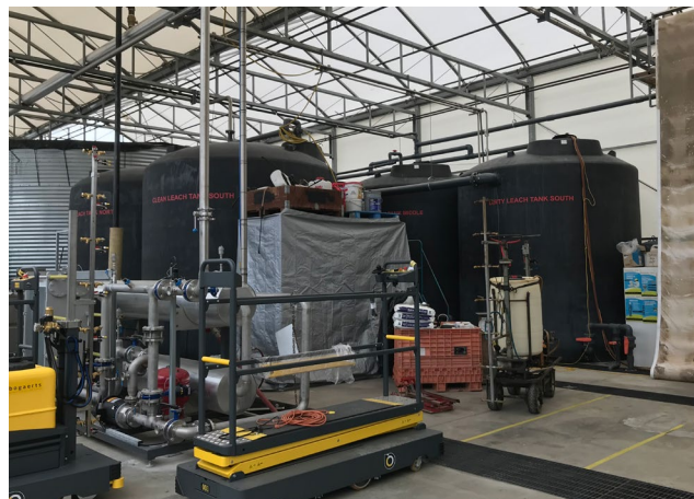
Figure 19. Système de désinfection thermique (pasteurisation) (à gauche) et réservoirs d'eau propre et sale (à droite).
