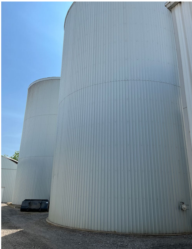
Figure 36. Réservoirs de stockage d'eau chaude.
